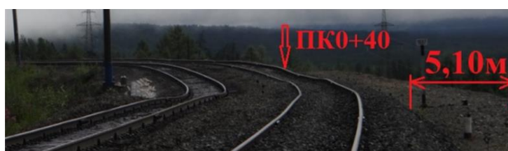
Рис. 5. Оползание первого и второго пути 1687 км ПК10 – 1688 км ПК1, июль 2020 г Fig. 5. Landslide first and second tracks 1687 km PK10 – 1688 km PK1, July 2020
