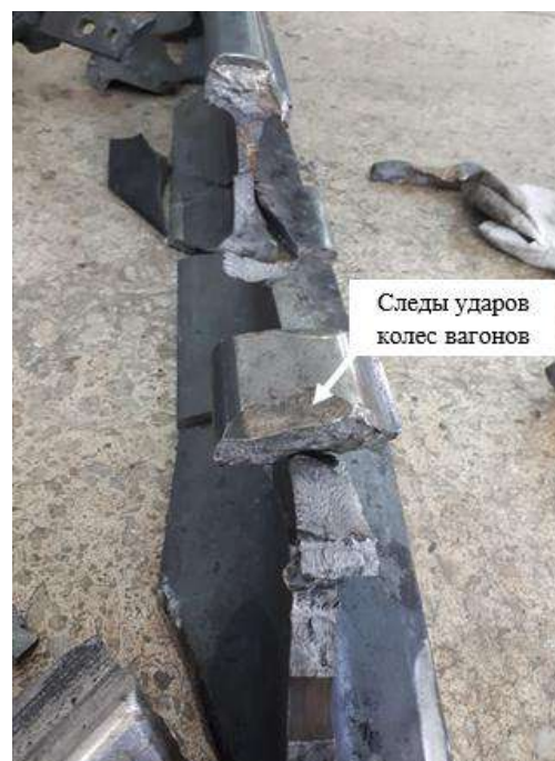
Рис. 1. Фрагменты разрушения рельса после схода (16 марта 2021 г.)
