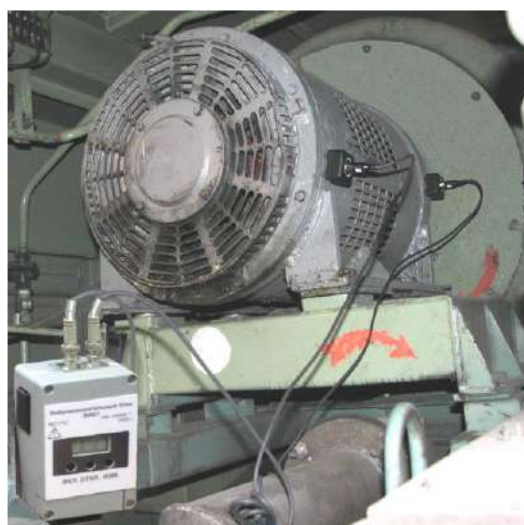
Рис. 3. Установка двухканального виброизмерительного блока и его датчиков вибрации на МВ2 Fig. 3. Installation of a two-channel vibration measuring unit and its vibration sensors on MV2
