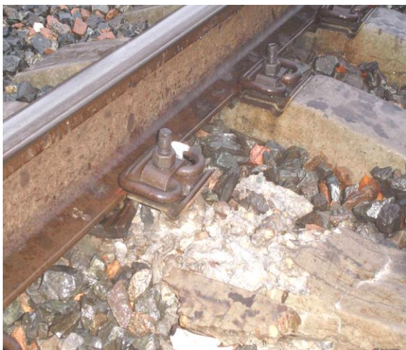
Рис.1 Разрушение структуры ж/б шпалы
