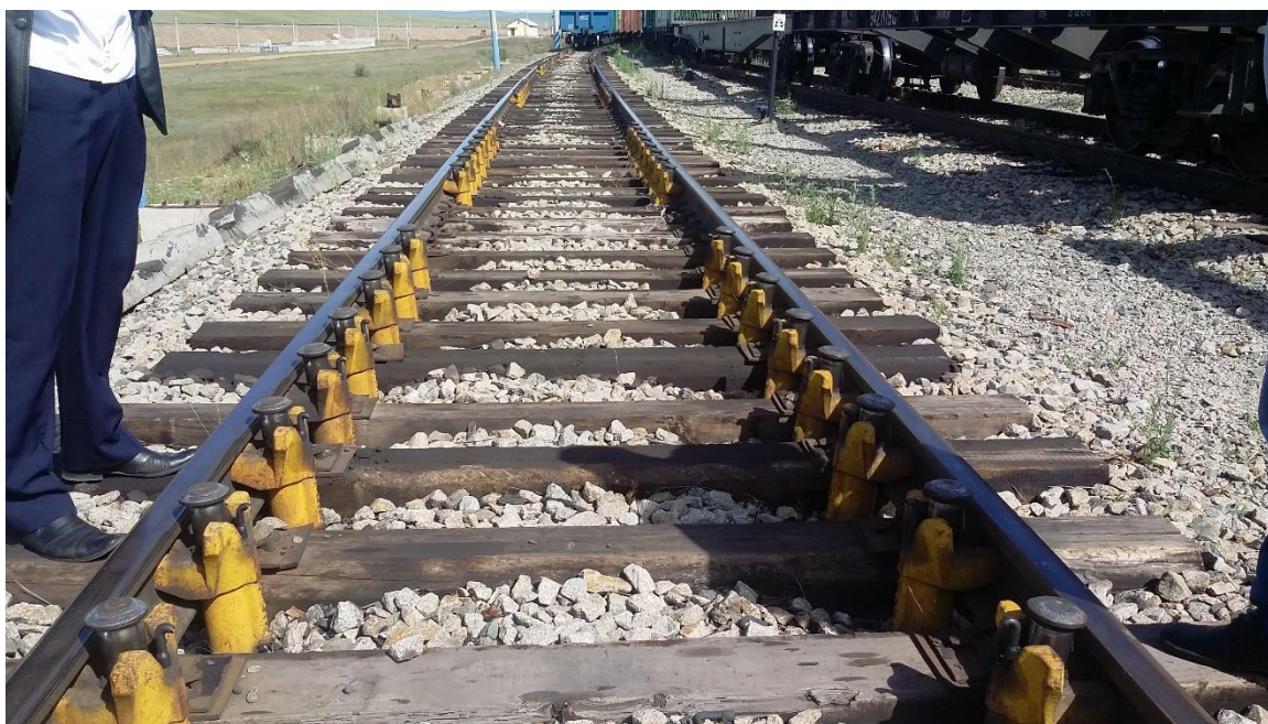
Рис. 1. Общий вид установки домкратовидных точечных замедлителей на сортировочном пути
