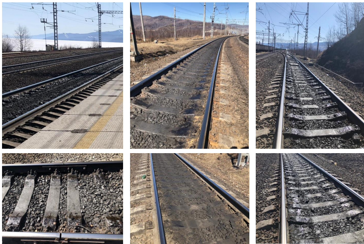
Рис. 5. Загрязнение балластного слоя железнодорожного пути на станции Слюдянка-2
