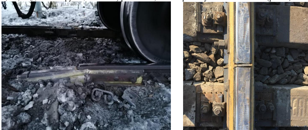
Рис. 3. Неисправности и дефекты рельсовых стыков в эксплуатации
