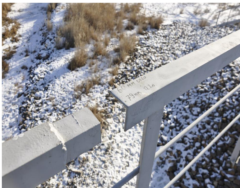
Рис. 8. Зазор секции перильного ограждения
