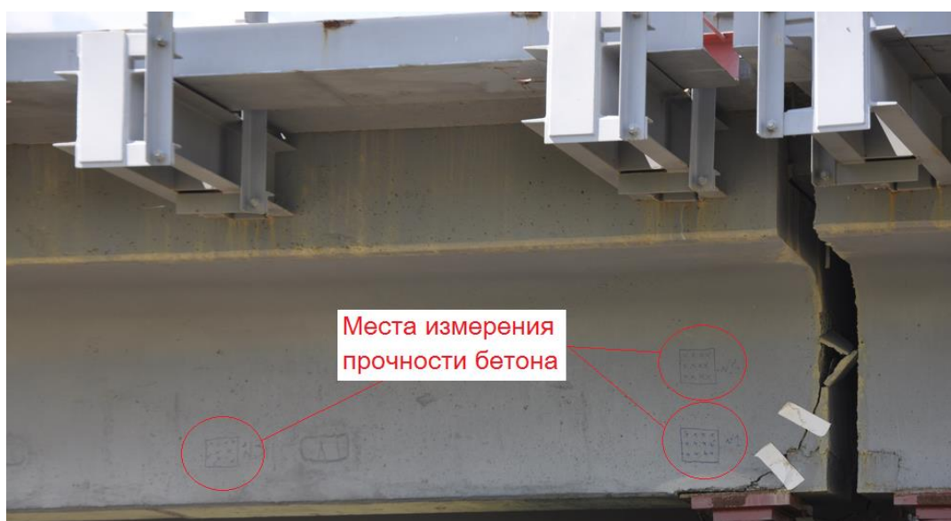
Рис. 2. Состояние пролетного строения в августе 2018 г. (правая балка)
