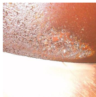
Рис. 19. Износ лопаток рабочего колеса в результате кавитации Fig. 19. Cavitation defect on the pump impeller
