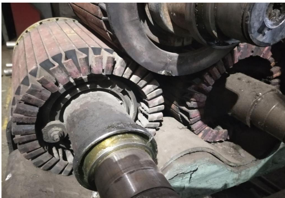
Рис. 1. Состояние ротора НВА55С Fig. 1. The state of the NVA55S rotor
