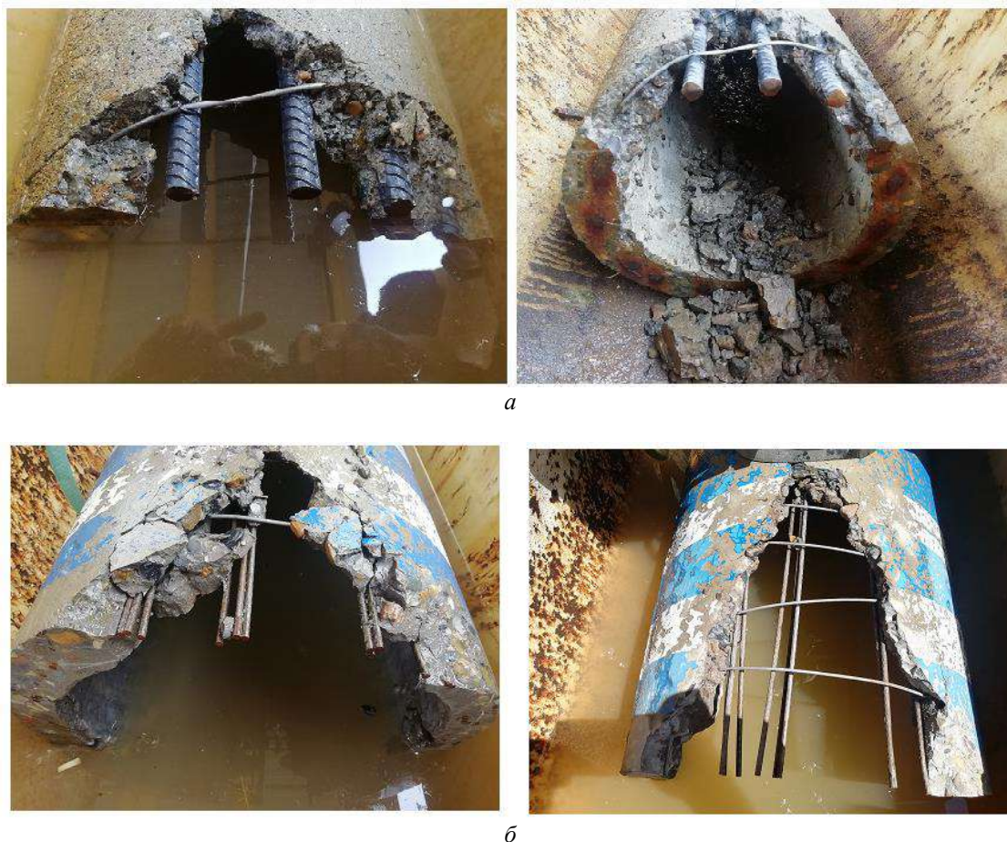
Рис. 3. Процесс отслоения бетона от арматуры после приложения испытательных воздействий к железобетонной опоре типа:
