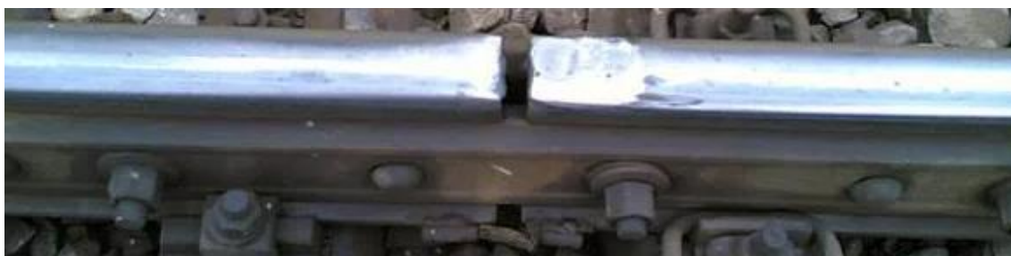
Рис. 8. Результат от горизонтального импульса в рельсовом стыке Fig. 8. The result of the horizontal pulse in the rail joint
