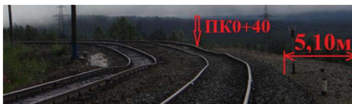
Рис. 5. Оползание первого и второго пути 1687 км ПК10 – 1688 км ПК1, июль 2020 г
