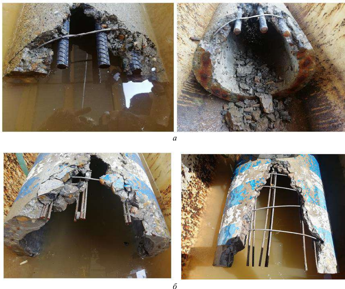
Рис. 3. Процесс отслоения бетона от арматуры после приложения испытательных воздействий к железобетонной опоре типа:
