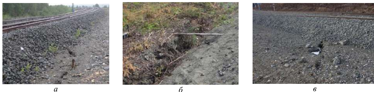
Рис. 4. Трещины отрыва оползня 1687 км ПК10 – 1688 км ПК1:
